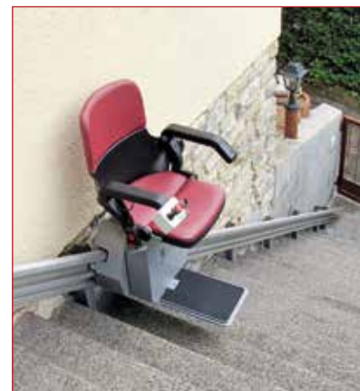
Lifte im Freien erhalten entsprechenden Wetterschutz.
