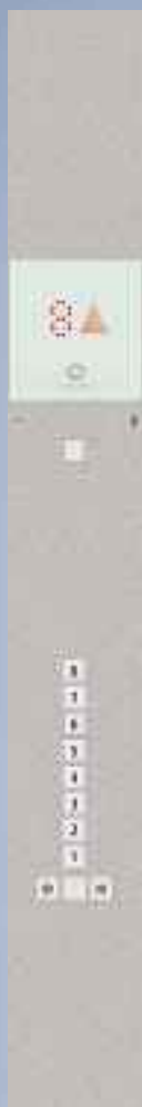
Панель управления в кабине
